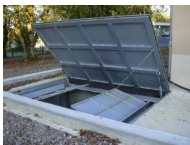
Trappe sur vérins hydrauliques (source Compte.R)
