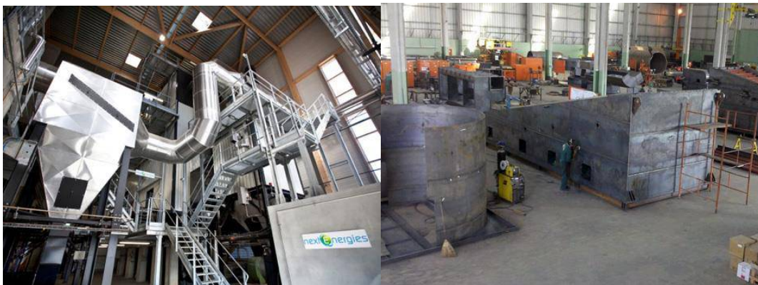
Figure 36: chaufferie de l'entreprise HCI
